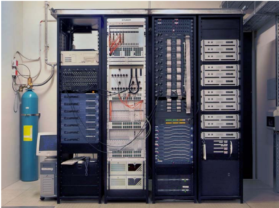
Az erősítő szoba a teljes hangrendszer „gépterme”. Baloldalt a hangszugárzók vezérlési eszközei, valamint a Színházat behálózó tartalékvonal végződések találhatóak, az „ezüst csik” a digitális keverő központja (vezérlő PC-k, DSP, optikai patch...stb.), a jobboldali két szekrény az ügyelői rendszer központi berendezéseit tartalmazza.
