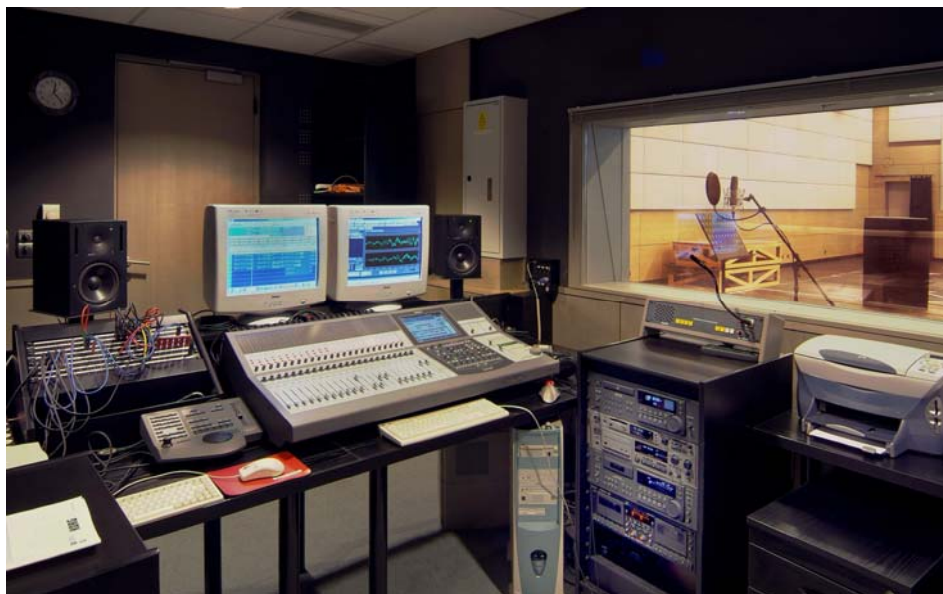
A hangfelvételi stúdió technikai helyisége digitális keverővel, bejátszó, felvevő és hangszerkesztő berendezésekkel. A jobboldalon látható próbaszínpad felvételi helyszíneként, de színpadi rész-próbák lebonyolítására is alkalmas
